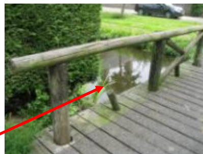
Figuur 4.2: Een reële kans op risicoaansprakelijkheid. Hier is direct herstel – klein onderhoud – vereist.
